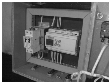
Figura 15 – Instalação e parametrização do CLP (Controlador Lógico Programável)
