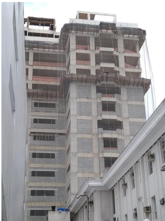
Figura 31 – Visão geral da tela fachadeira
