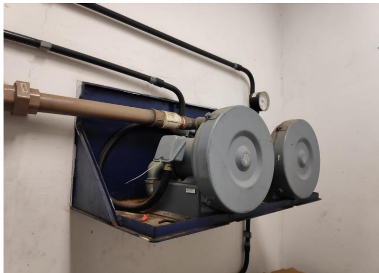
Figura 13 – Bombas de Vácuo
