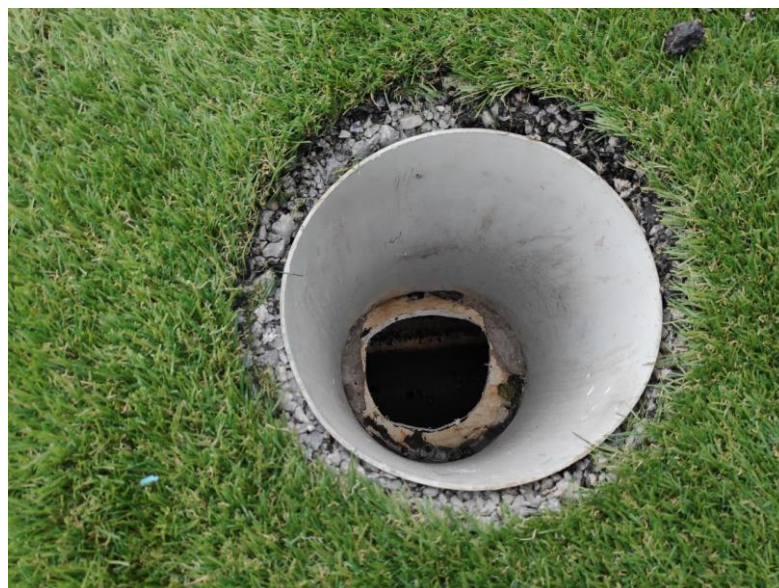
Figura 23 – Tubo de inspeção
