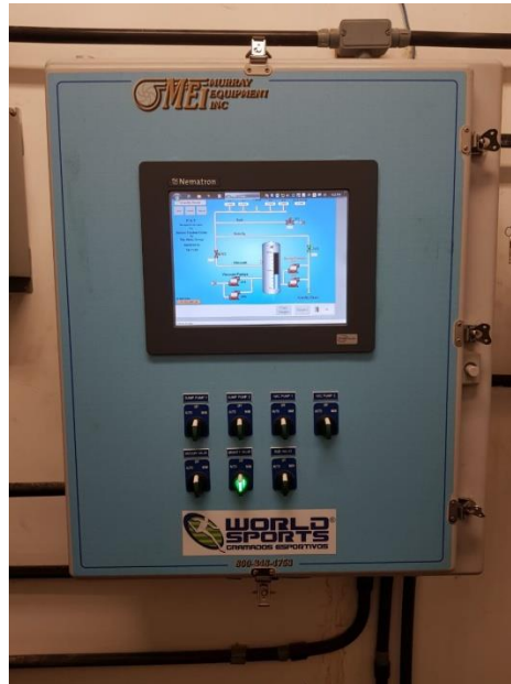
Figura 19 – Painel de Controle da Drenagem a Vácuo
