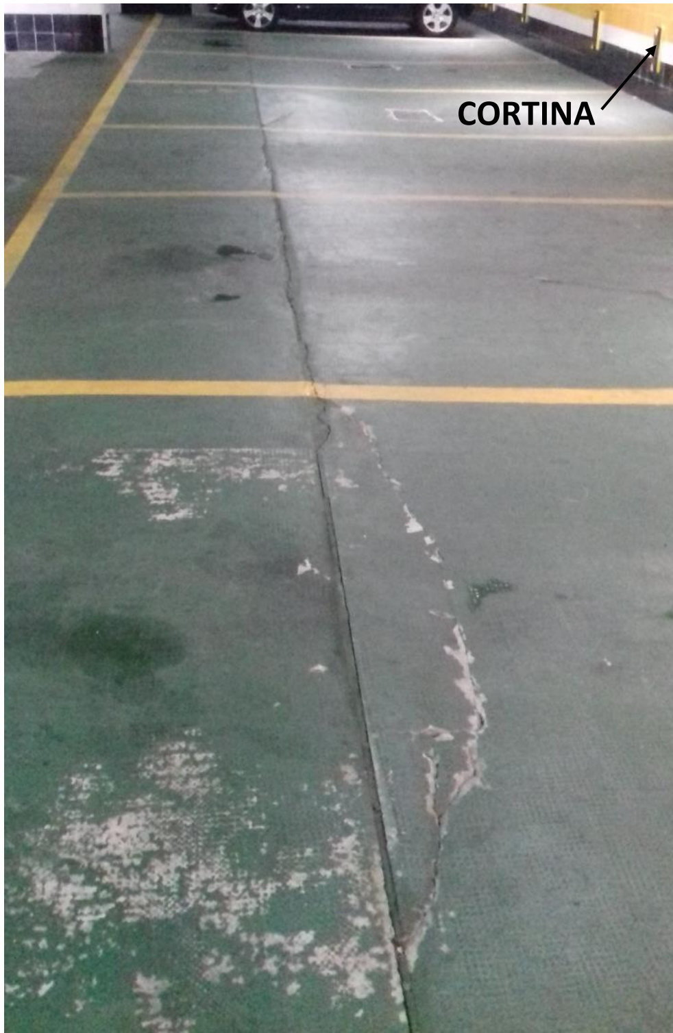
Figura 10 - Trinca no piso do subsolo (lado esquerdo).
