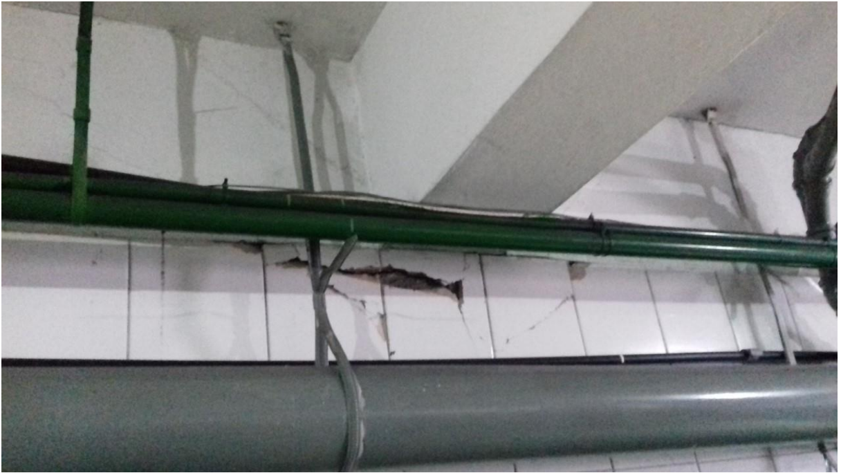
Figura 8 - Trinca na cortina de apoio da viga do Térreo
