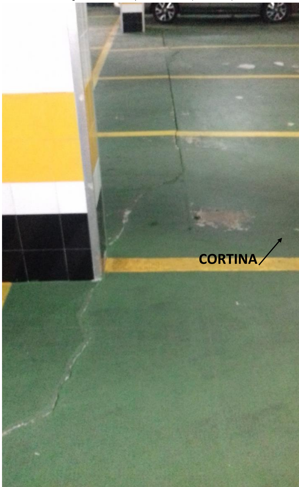
Figura 9 - Trinca no piso do subsolo (lado direito).
