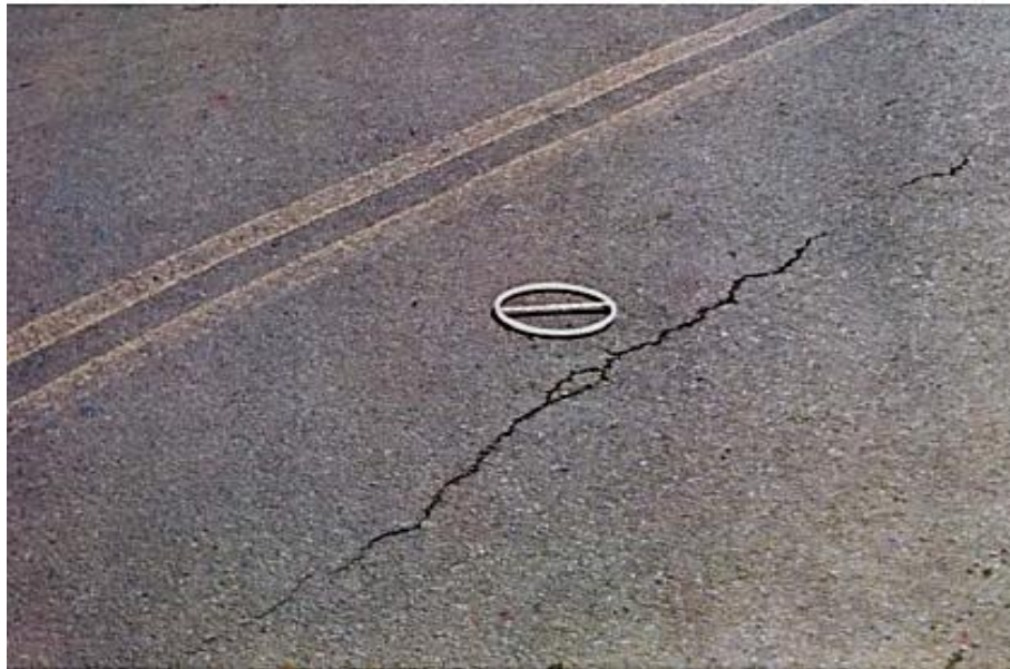
Figura 3 – Trinca isolada. Fonte: DNIT (2003)
