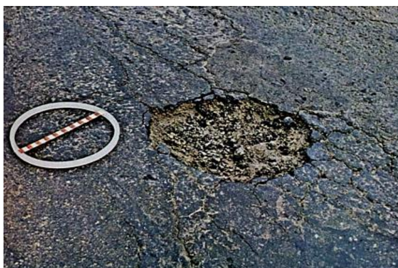
Figura 8 – Panela ou buraco. Fonte: DNIT (2003)
