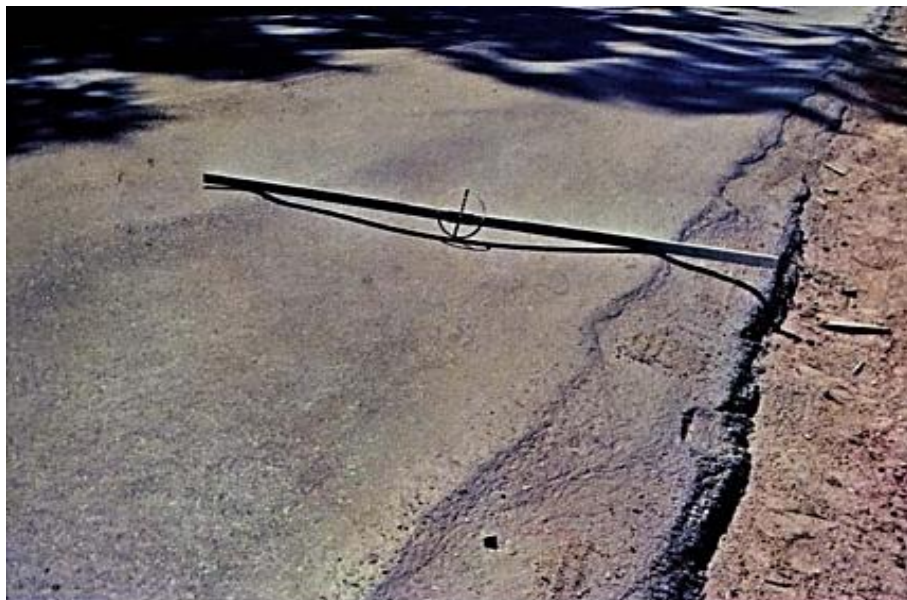
Figura 4 – Afundamento de trilha. Fonte: DNIT (2003)
