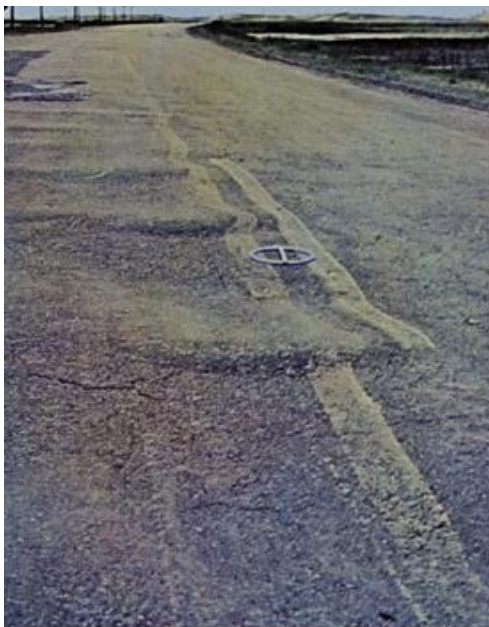
Figura 5 – Ondulação. Fonte: DNIT (2003)
