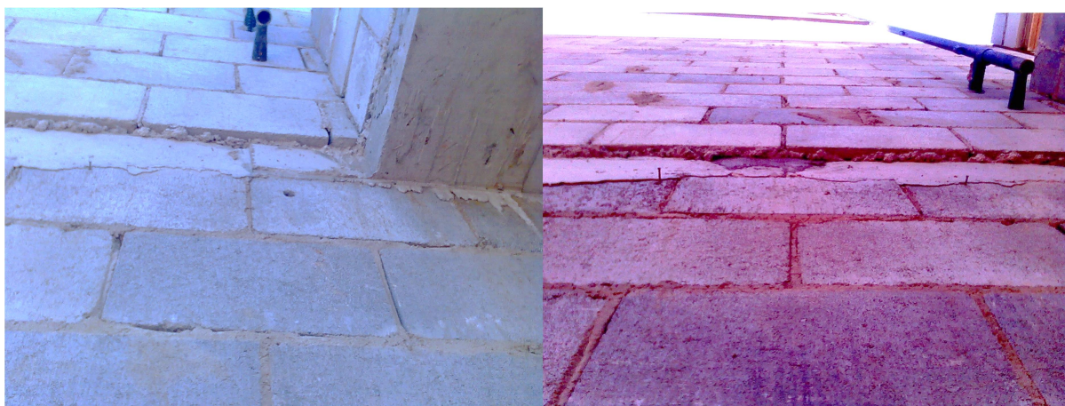
Figura 26: Paredes fora de prumo (Silveira, 2016)
