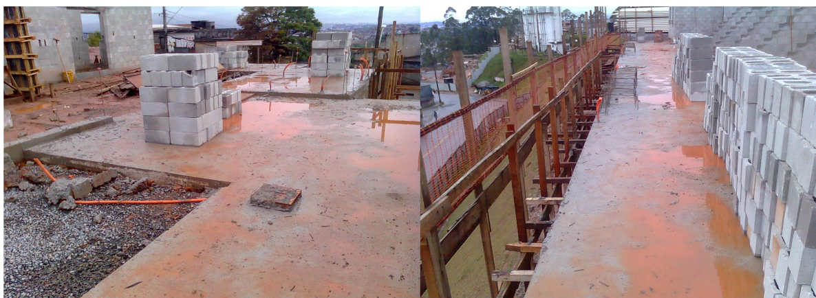
Figura 20: Blocos armazenados de forma incorreta (Silveira, 2016)
