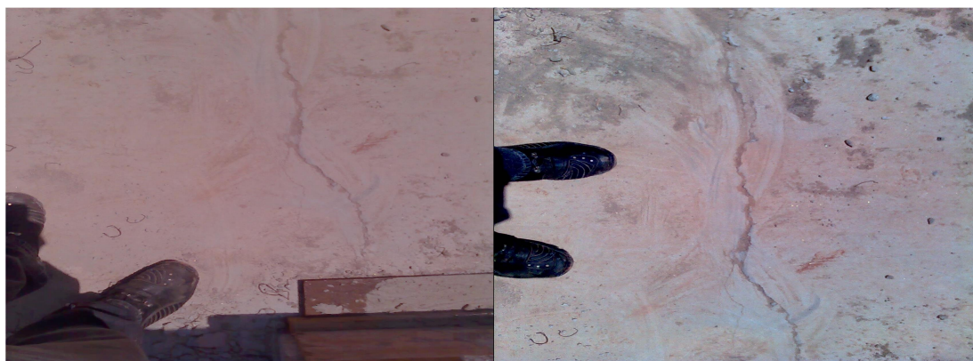
Figura 33: Falta de junta de dilatação (Silveira, 2016)
