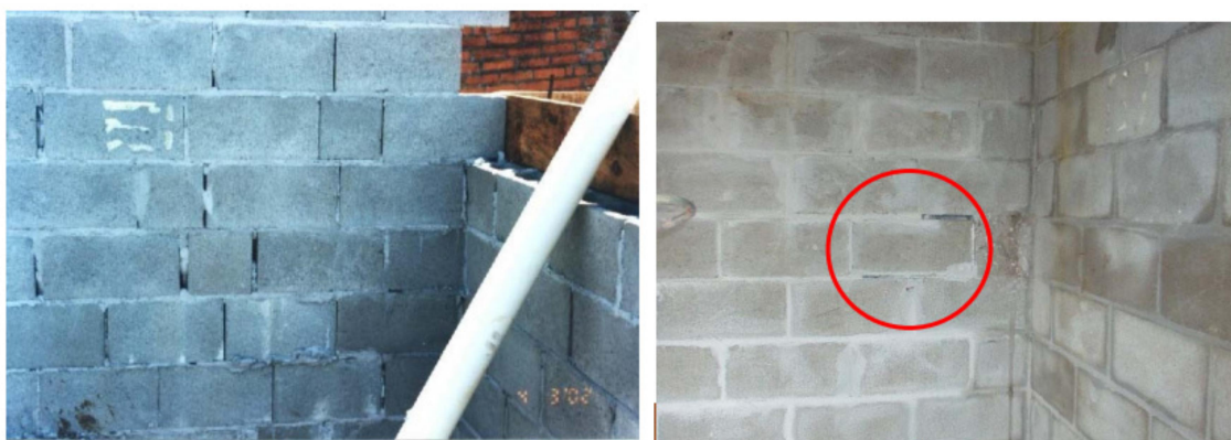
Figura 12: Preenchimento inadequado de juntas (Sousa, 2011)
