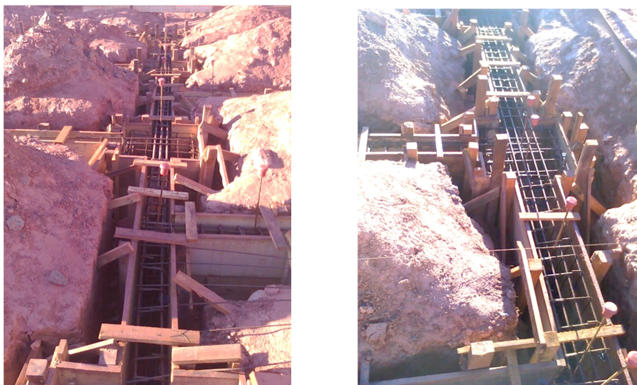
Figura 18: Fundação sem uso de espaçadores (Silveira, 2016)
