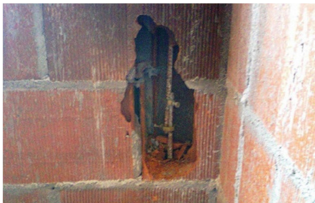
Figura 15: Grauteamento incorreto (Sousa, 2011)
