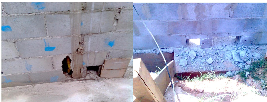
Figura 28: Caixas de graute mal cortadas (Silveira, 2016)
