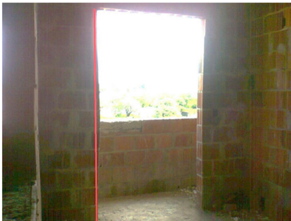
Figura 13: Falta de prumo (Sousa, 2011)
