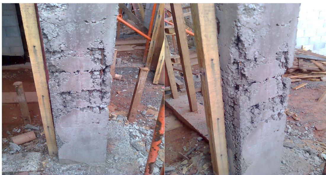
Figura 37: Consequência da má vibração dos pilares (Silveira, 2016)
