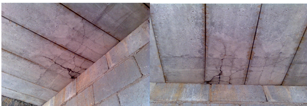
Figura 35: Lajes quebradas (Silveira, 2016)
