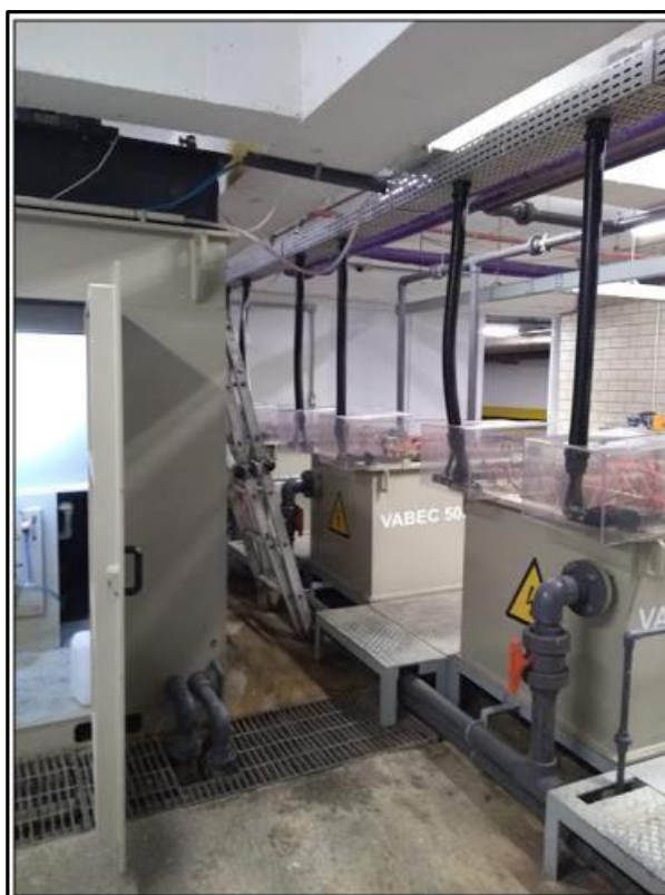
Figura 11 - Parte da ETE/Reúso do Shopping Center em questão.
