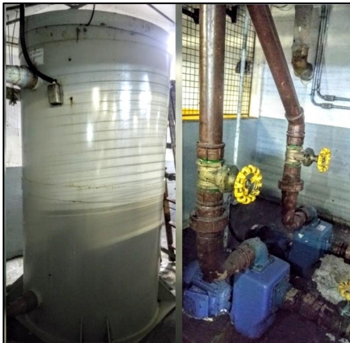
Figura 16 - Reservatório da PA e bombas de recalque pré ETE.
