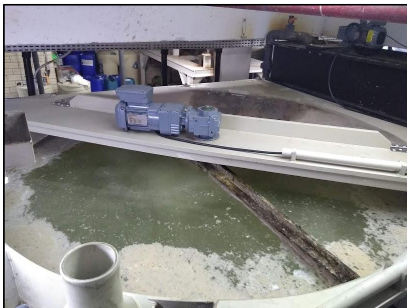
Figura 22 - Remoção do lodo floculado.
