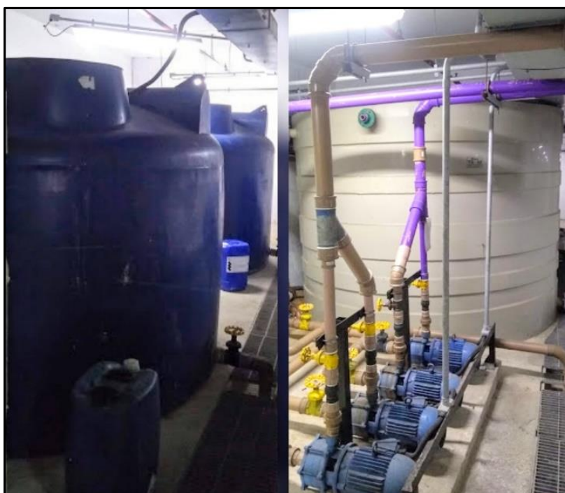
Figura 26 - Reservatórios de água tratada de 10.000 L e 15.000 L.
