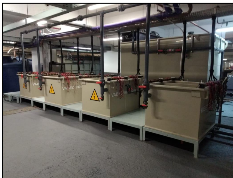
Figura 20 - Caixas de baterias de eletrocoagulação.
