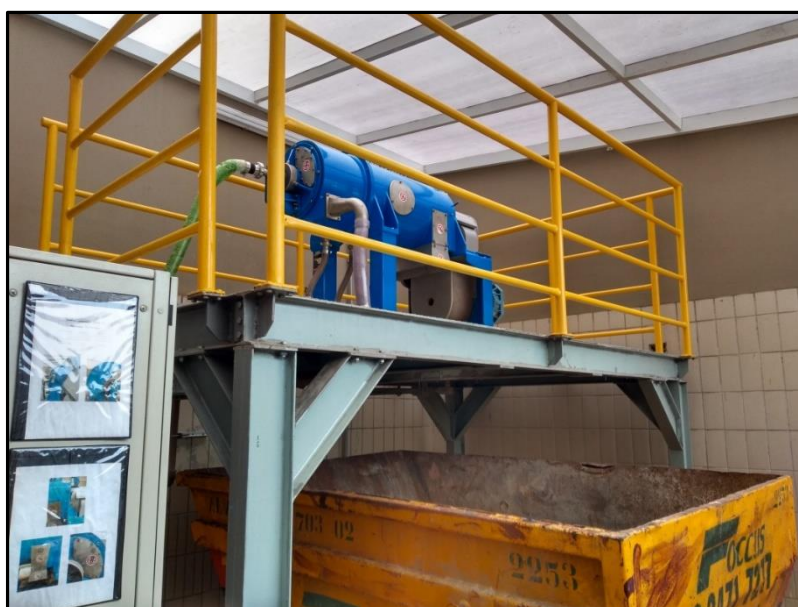
Figura 23 - Centrífuga do lodo.
