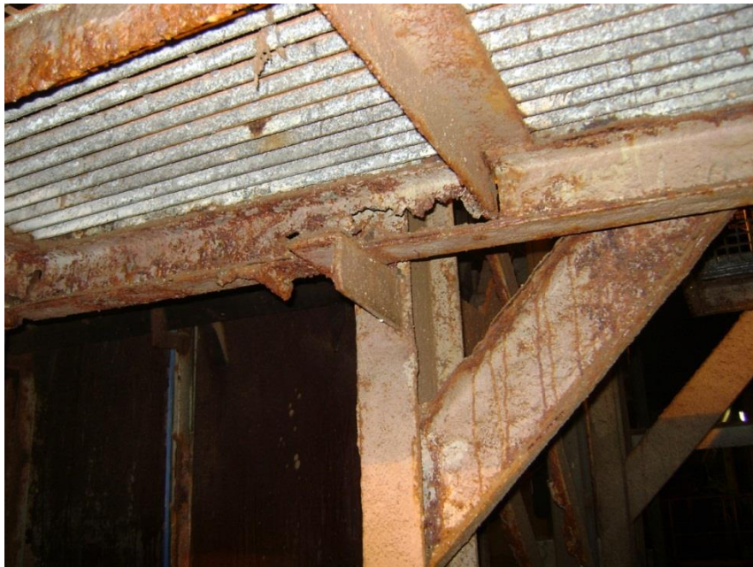
Figura 8 – Estrutura com corrosão – Fonte: http://www.conerge-engenharia.com.br/datafiles/suite/escritorio/aplicativo/conteudo/album_fotografico/482.jpg
