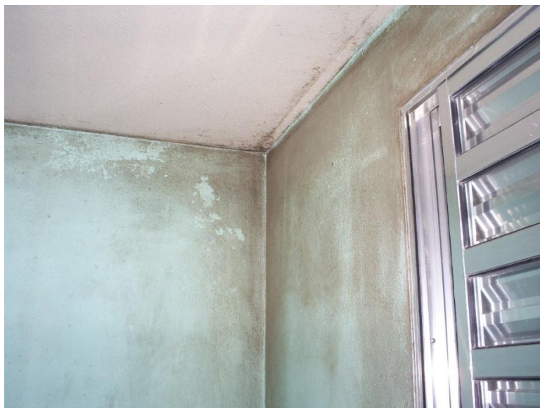
Figura 4 – umidade interna devido fissura externa nas paredes (próprios autores).
