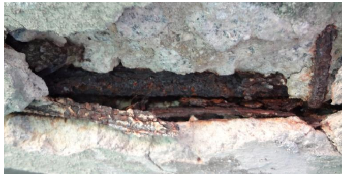
Figura 1 – Exposição e corrosão da armadura (próprios autores).
