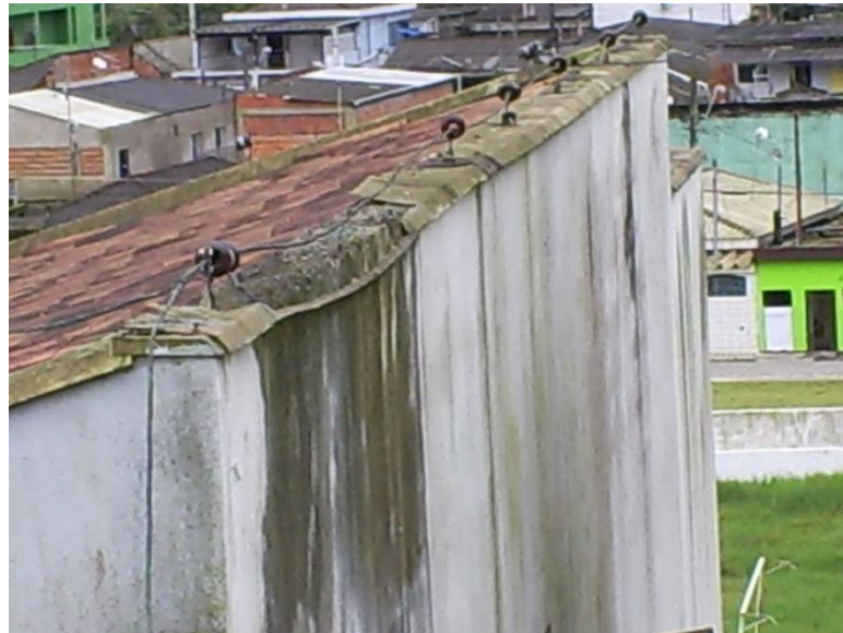
Figura 12 – Problemas no rufo do telhado (próprios autores).
