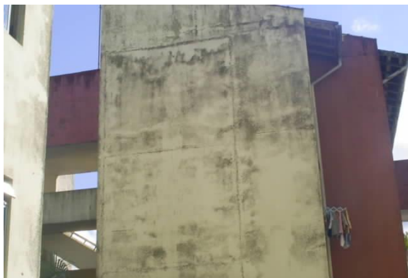
Figura 14 – Fachada Sul com manchas e umidade (próprios autores).
