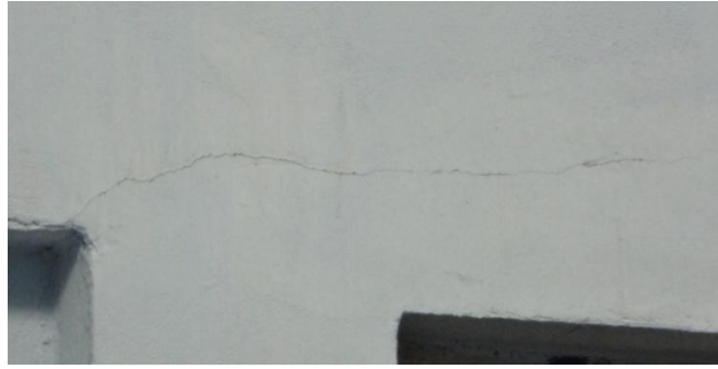
Figura 2 – Fissura (próprios autores).
