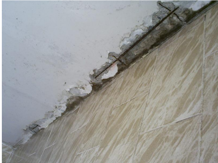
Figura 5 – Corrosão de armadura (próprios autores).
