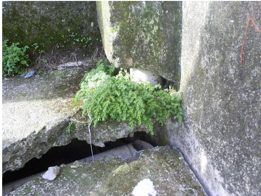
Figura 10 – Recalque na calçada com rompimento da tubulação de águas pluviais (próprios autores).
