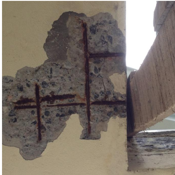
Figura 6 – Corrosão por falta de recobrimento na ferragem (próprios autores).
