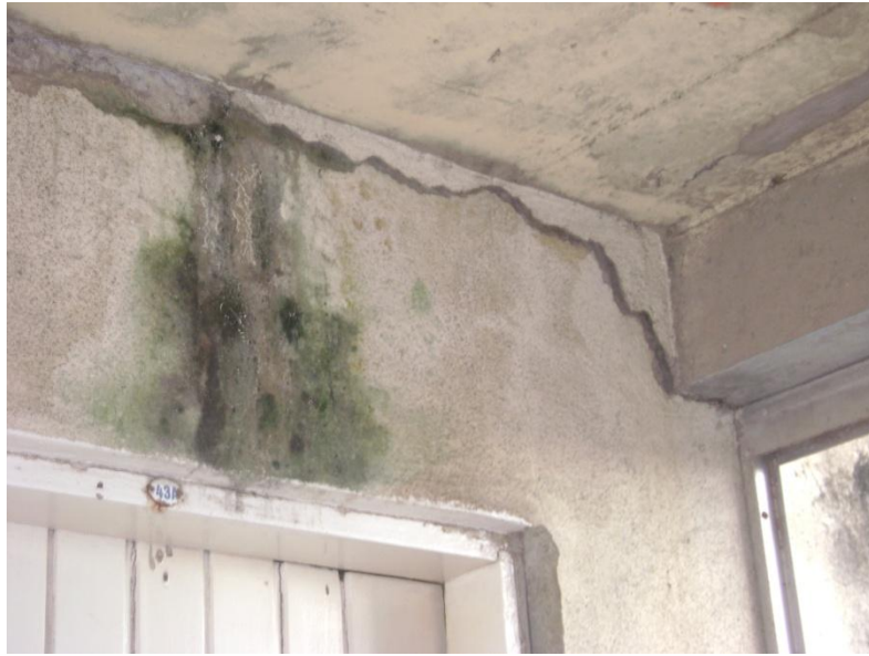
Figura 11 – Infiltração em lajes e paredes (próprios autores).
