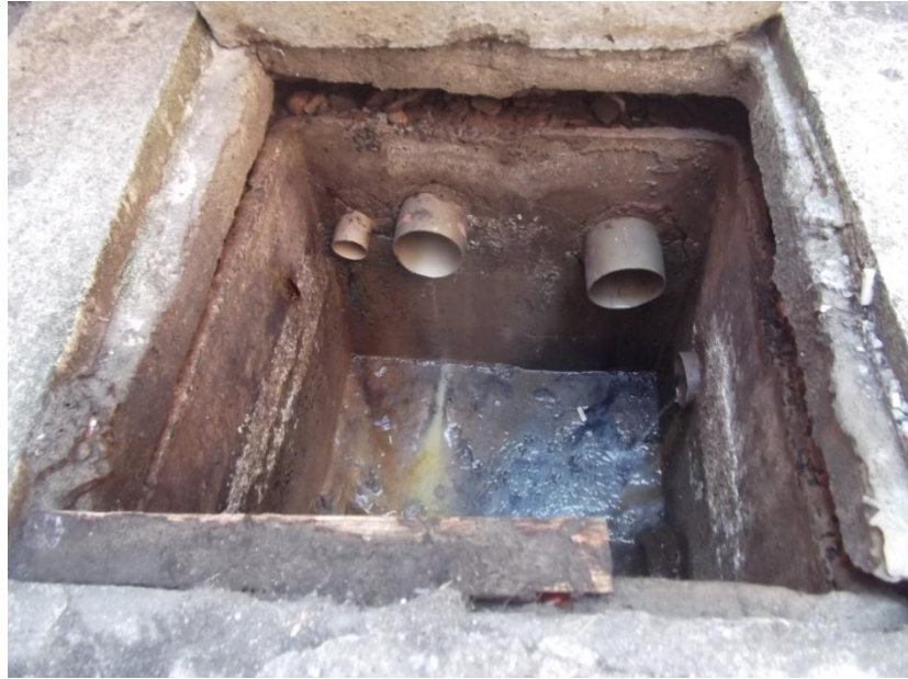
Figura 9 – Recalque na caixa de esgoto por movimentação no terreno (próprios autores).
