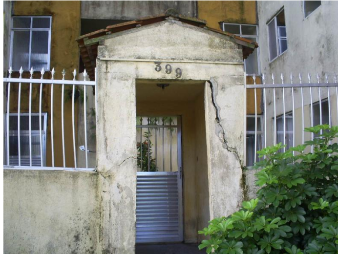
Figura 7 – Trincas no muro de fachada (próprios autores).
