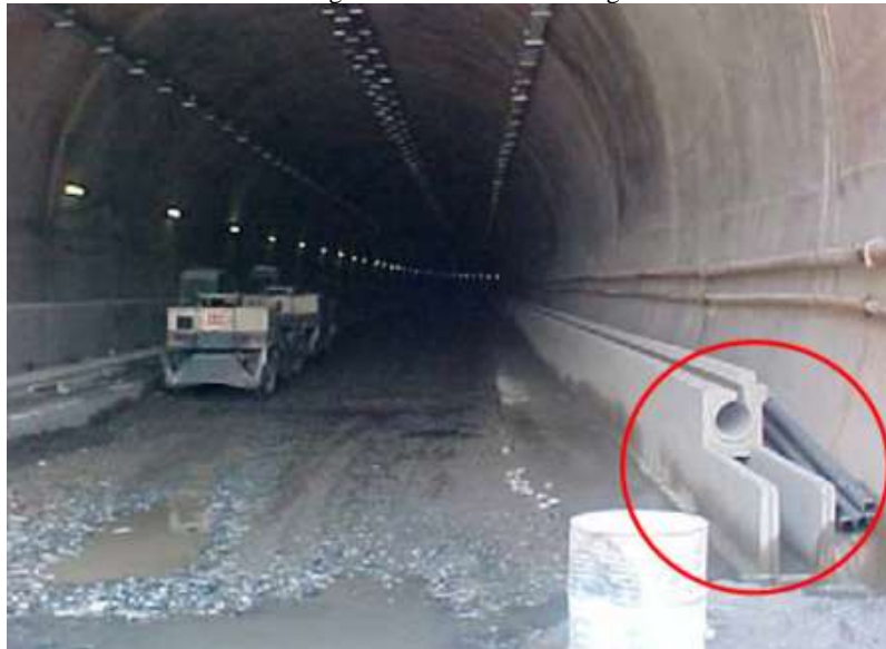
Figura 11: Sistema de drenagem túneis
