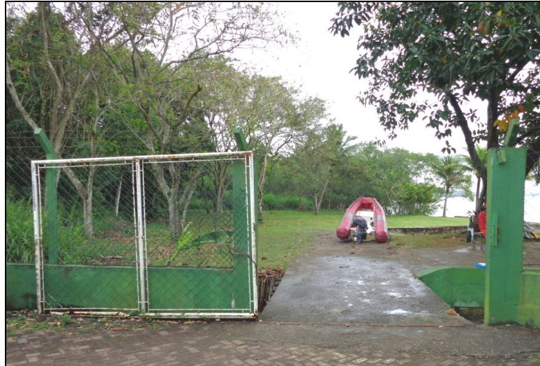
Figura 8: Portão em alambrado em avançado processo de corrosão
