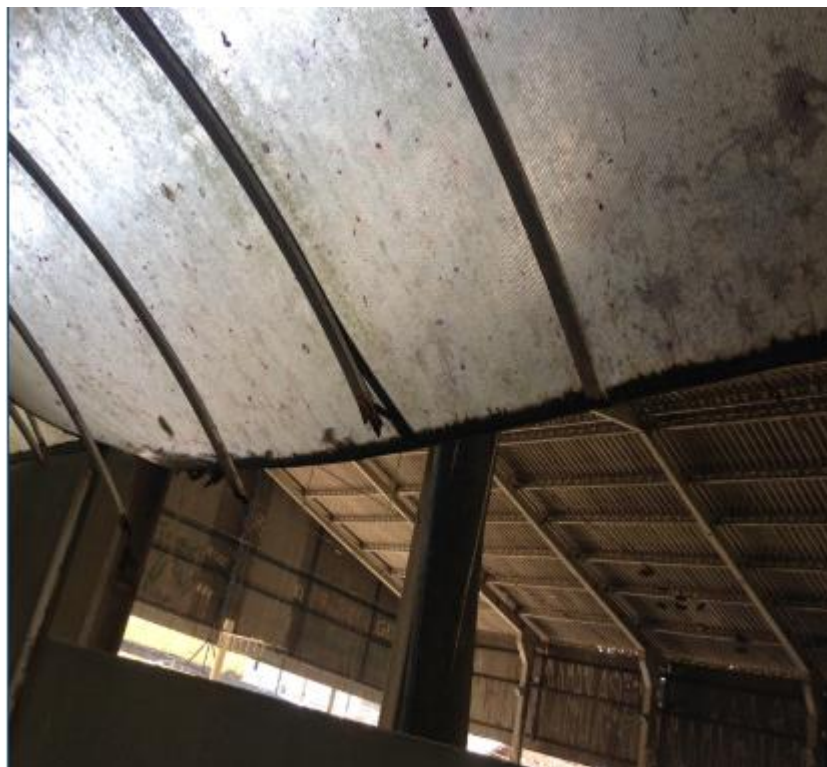
Figura 6: Estrutura da cobertura de policarbonato deteriorada
