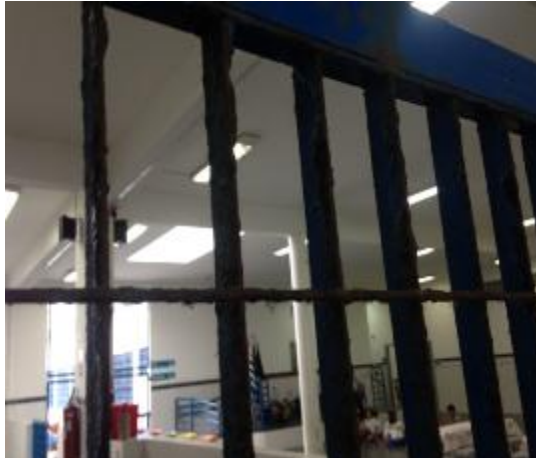
Figura 11: Barras verticais e horizontais com corrosão avançada, no portão tipo gradil
