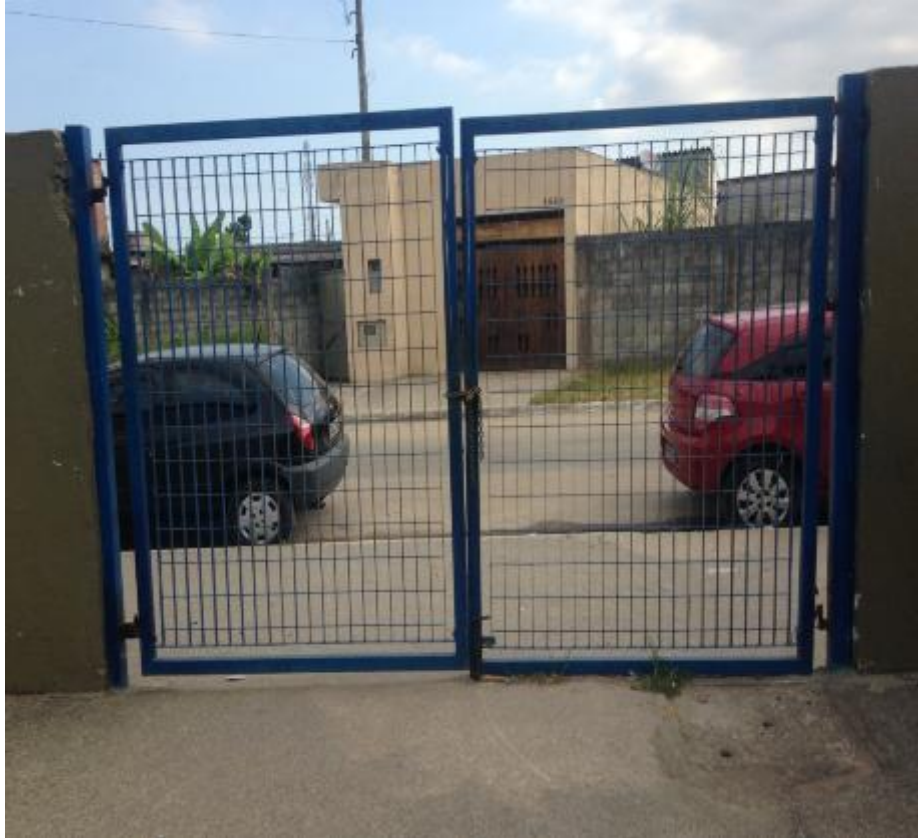
Figura 12: Portão tipo gradil de duas folhas vandalizado, solicitada a troca por portão de correr
