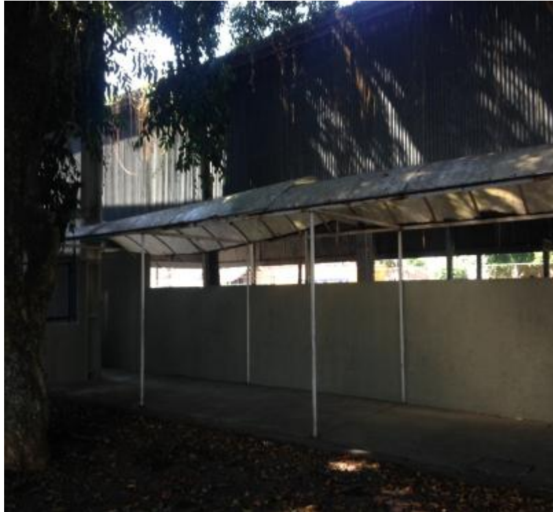
Figura 7: Cobertura que foi substituída, tendo em vista avançado processo de corrosão
