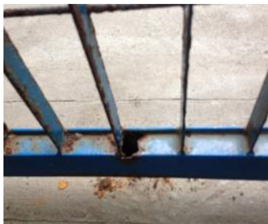
Figura 10: Detalhe dos pontos de corrosão no portão tipo gradil
