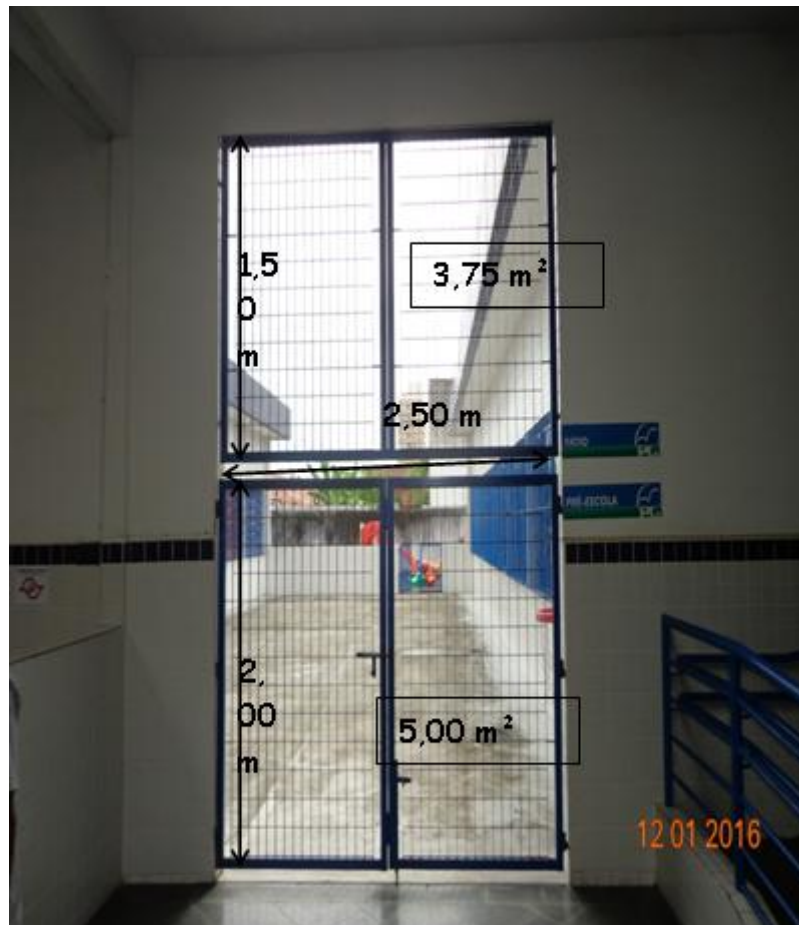
Figura 9: Portão tipo gradil em avançado estado de corrosão
