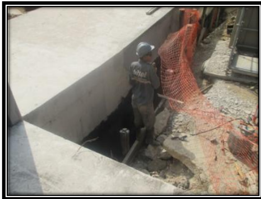
Figura 9 - Túnel externo, interligado com o poço do elevador lado Norte da obra.
